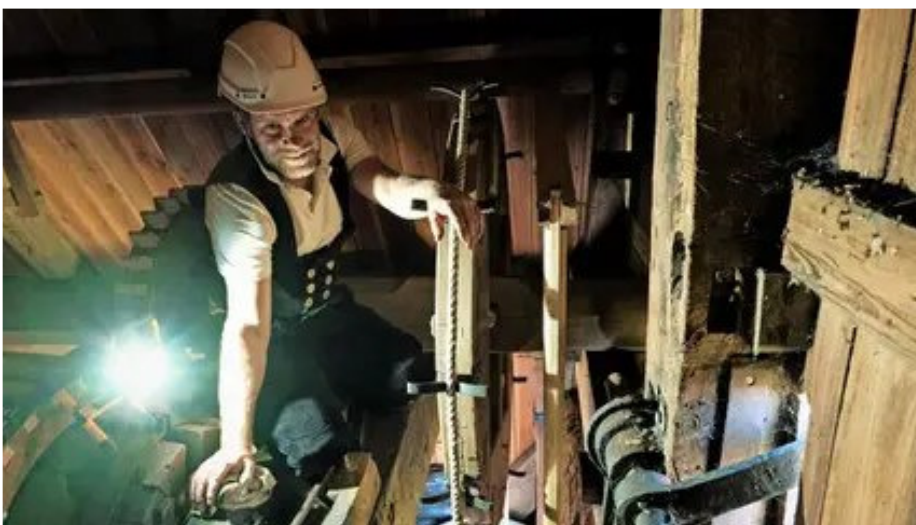
Überprüft die Jalousiesteuerung: Michael Springer, Inhaber der beauftragten und in Wettmar ansässigen Zimmerei „Der Holzmiel“.
