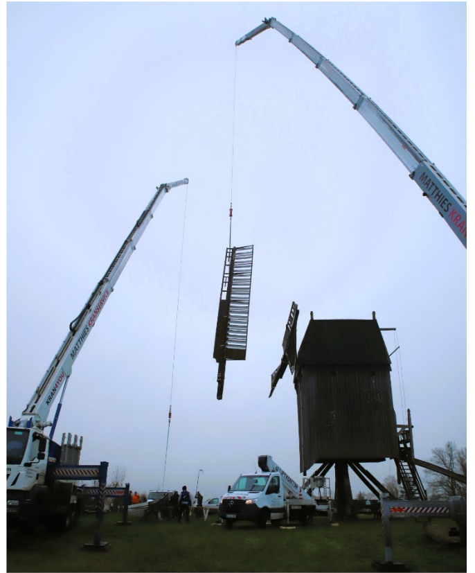
Der Flügel mit dem defekten Bruststück ist demontiert.
